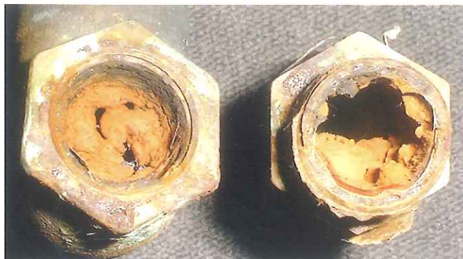
継手断裂部断面近影(漏水箇所:二次側バルブ周り配管) 漏水当時:築22年・7階建て・26戸(VLP使用物件)
